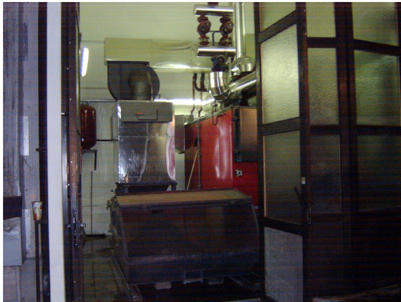
Heizungsbrand Tischlerei Kornmüller
